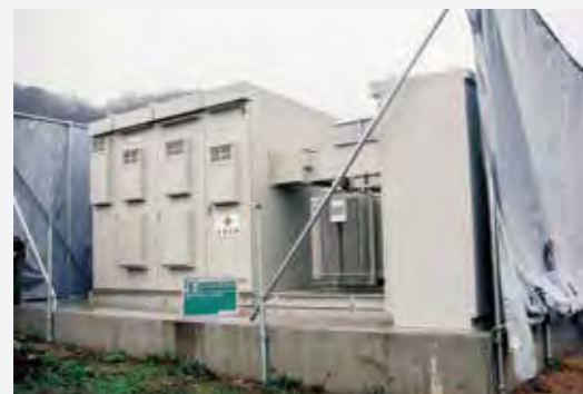
稼働音が敷地境界に影響していました。
