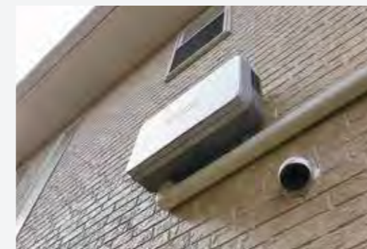
高周波音が近隣住宅に影響していました。
