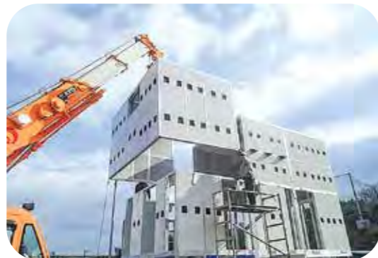
現場でのスムーズな施工のため、事前に仮組みを行います。
